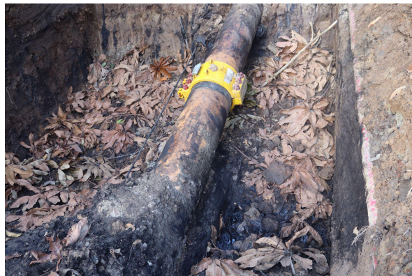
Foto: Oleoducto defectuoso Latitude S 0.371015°, Longitude W 76.698412°
